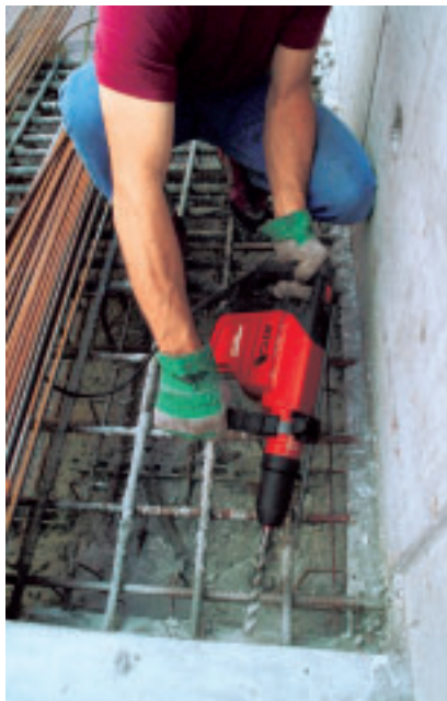
Uvolněné vrtání kotevních otvorů vzhledem k použitému systému ochrany obsluhy ATC.
